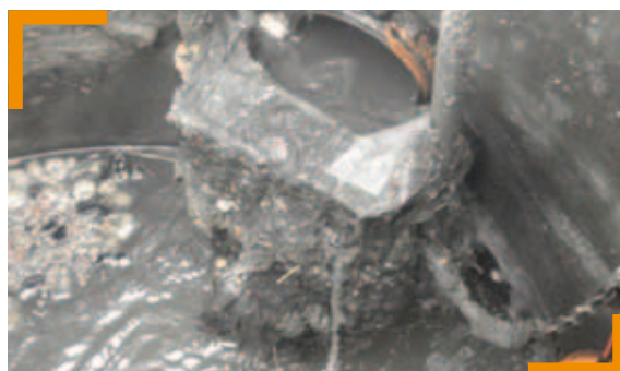
Accumulation de déchets dans une pompe
