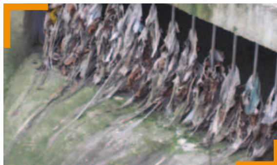
Lingettes obstruant une grille du réseau
