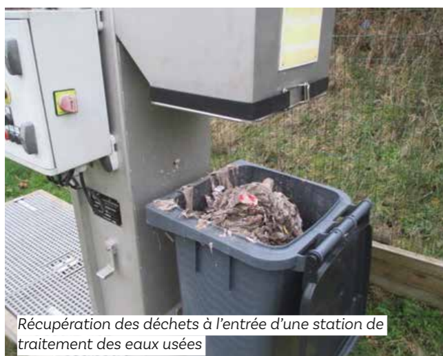
Lingettes obstruant une grille du réseau
