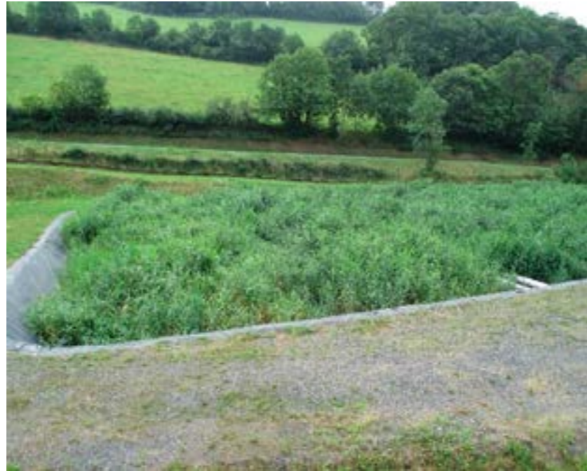
Station de Traitement des Eaux Usées à filtres plantés de roseaux à la Brally à Yzeron.
